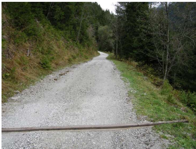
Figur 11. Korsdiken tvärs vägar i Österrike. Utförs då vägen sluttar brant och risk finns att vattnet får så hög fart att det kan erodera vägbanan eller då man vill hindra vatten från att fortsätta längs vägen och påverka objekt nedanför. Foto: SGI.
