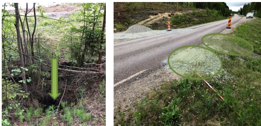
Figur 54. Bildning av hål i nedre vägsblänt samt lagning av uppkomna hål. Foton: Erik Eriksson, Trafikverket
