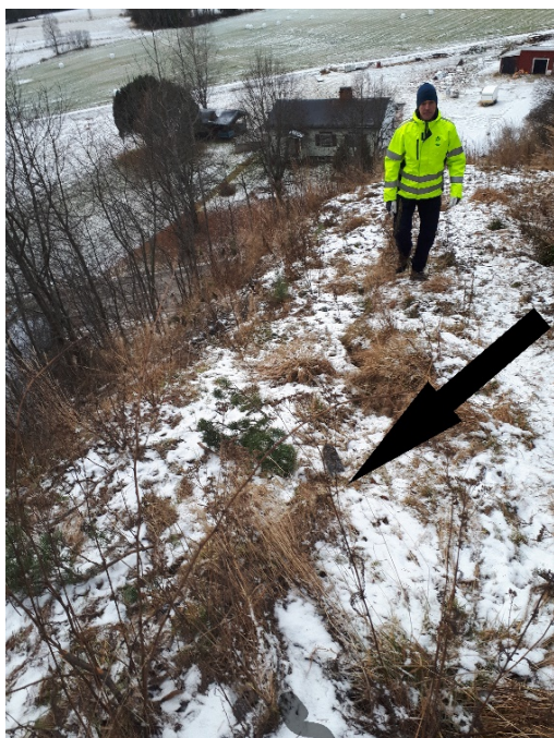
Figur 26. Ytterkanten på den branta basvägen har börjat spricka med fara för att den ska rasa ned på väg 62, samt ett mindre uthus i släntfot. Foto: A. Lomander, Skogsstyrelsen
