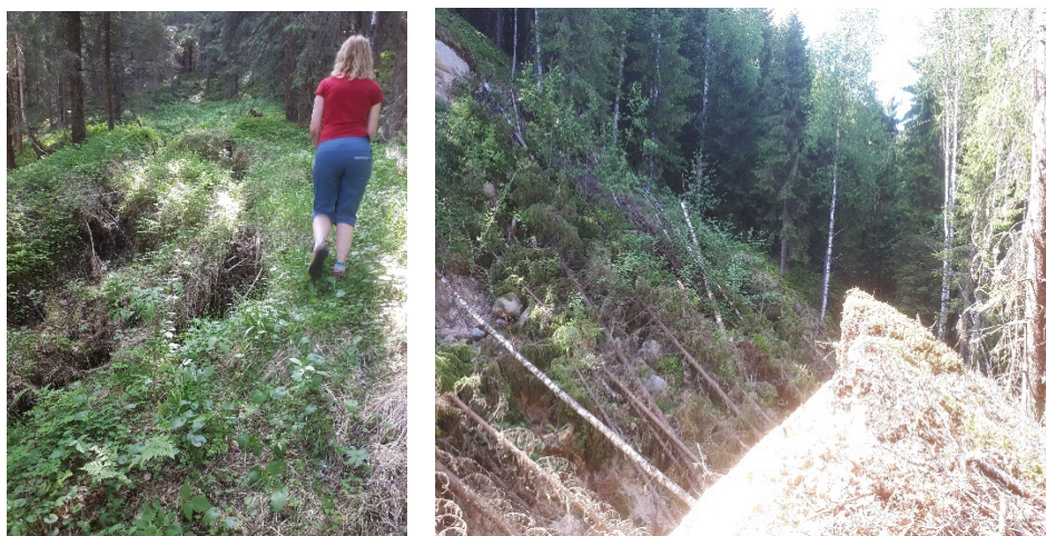
Figur 20. Vatten har koncentrerats till körspår (till höger) längs en basväg och orsakat ett omfattande ras längre ned i sluttningen (till vänster). Foton: A. Lomander, Skogsstyrelsen.
