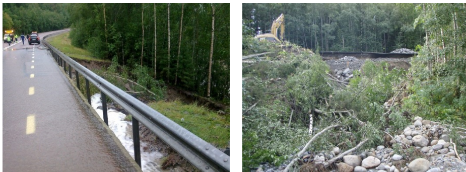
Figur 48. Vid det andra skadestället rasade den branta slänten ut mot älven. Foton: Stefan Johansson, Trafikverket.
