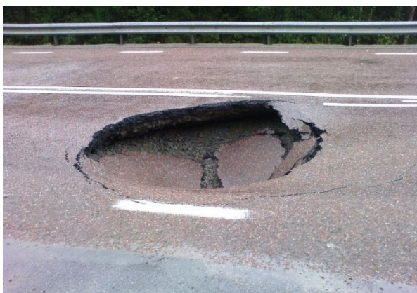
Figur 49. Vatten har eroderat bort material under vägbanan och en krater har uppstått. Foto: Stefan Johansson, Trafikverket.
