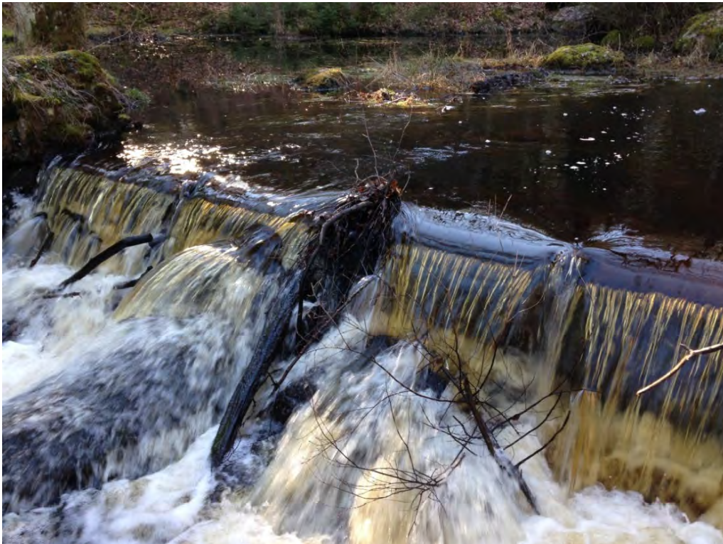
Bild 2. Närbild av öppningen i dammvallen.
