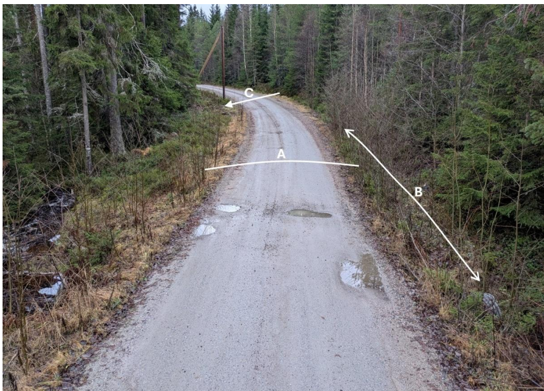
Figur 3. Vid trumma nr 5 diskuterades följande anpassningar/ åtgärder för att minimera grumling av vattendragets vatten. A: Körbanans bombering, det vill säga körbanans lutning från vägmitt mot körbanekanterna, åtgärdas så att vattnet på körbanan leds direkt ned i vägdikena. B: Vägdikessträckan lämnas orensad i möjligaste mån. C: En trumma kan anläggas som leder allt vatten från det högra vägdiket till det vänstra vägdiket. Vattnet i det vänstra vägdiket leds ut i terrängen. På detta sätt är det endast de närmaste tiotal metrarna från trumman vid vattendraget som bidrar till eventuell grumling.
